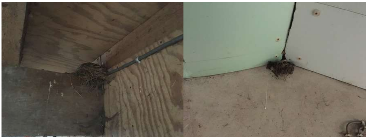
Foto links: oud nest van een merel. foto rechts: oud nest van een boerenzwaluw. Beide foto's zijn gemaakt in deelgebied Veerweg.
