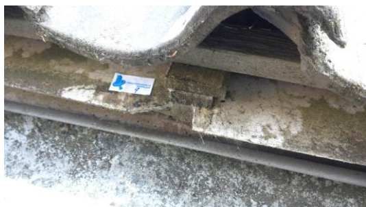
Foto 38 | dakbeschot van het bijgebouw
