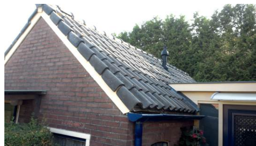
Foto 39 | dakbeschot van het bijgebouw
