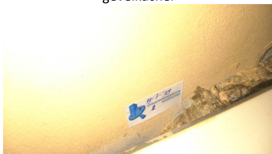
Foto 7 | koord achter asbesthoudende gevelkachel
