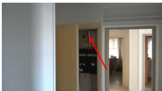
Foto 22 | strookje plaat in de meterkast
