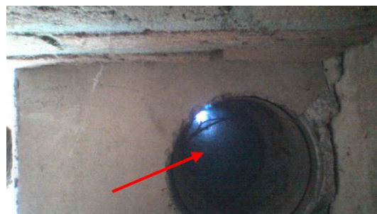
Foto 51 | rookkanaal begane grond
