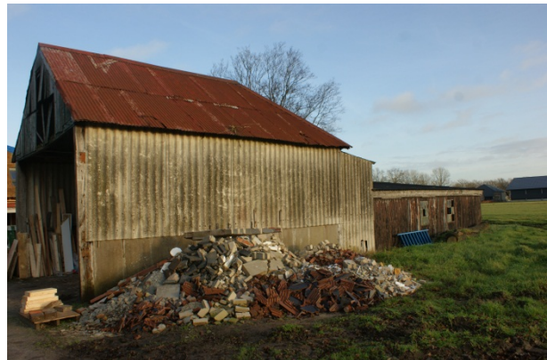
Schuur bedekt met asbesthoudenden en metalen platen
