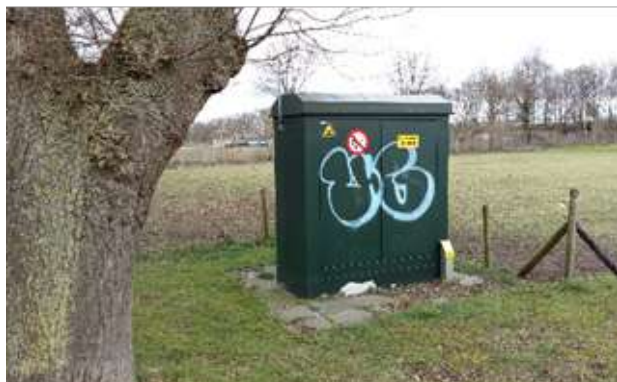
Trafohuisje noodzakelijk maar niet passend element op het erf met karakteristieke eiken
