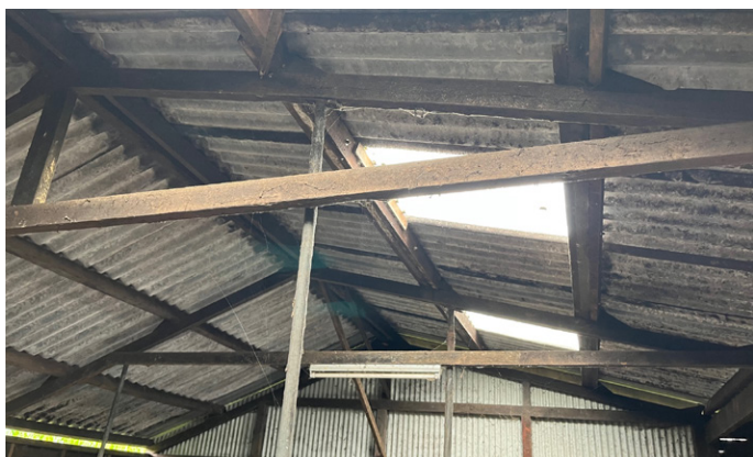
Afbeelding 5. Geen isolatie aanpalende schuur met ontbrekende dakdelen
