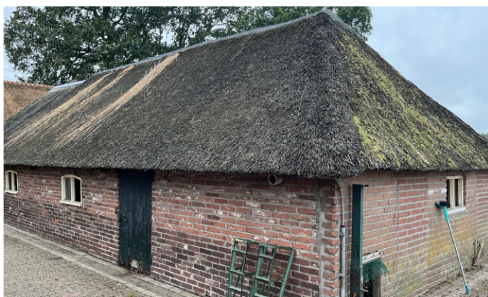
Afbeelding 9. Te amoveren schuur met ontbrekende ramen in kozijn en losgetrokken riet waardoor openingen in het riet zijn ontstaan
