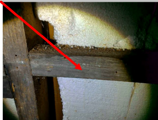
Foto 6 | Restanten plaat tegen regelwerk
