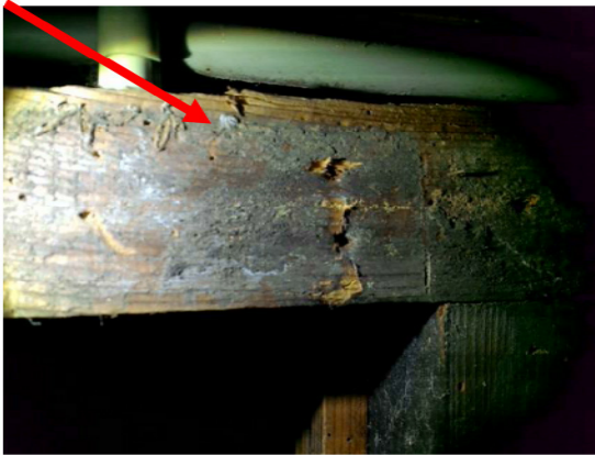
Foto 13 | Restanten plaat tegen regelwerk
