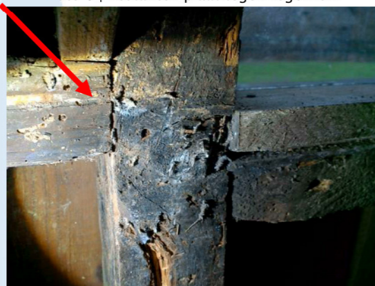
Foto 8 | Restanten plaat tegen regelwerk
