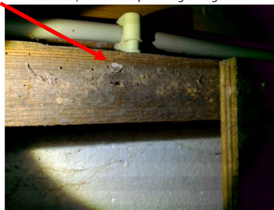
Foto 12 | Restanten plaat tegen regelwerk
