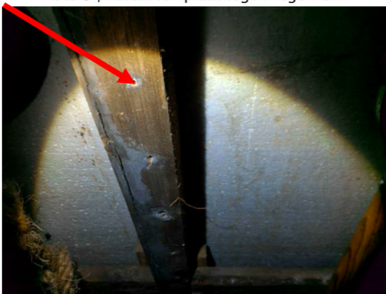
Foto 11 | Restanten plaat tegen regelwerk
