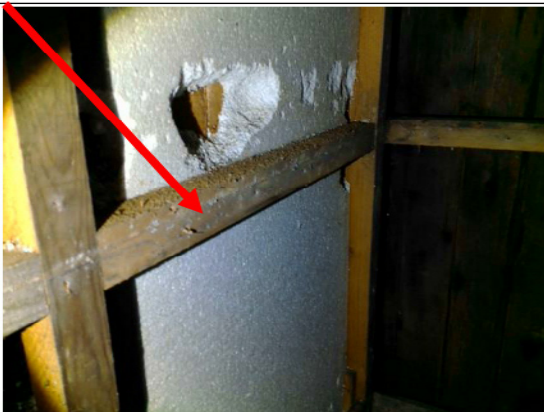
Foto 5 | Restanten plaat tegen regelwerk
