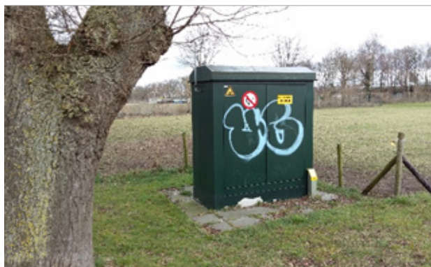
Trafohuisje noodzakelijk maar niet passend element op het erf met karakteristieke eiken
