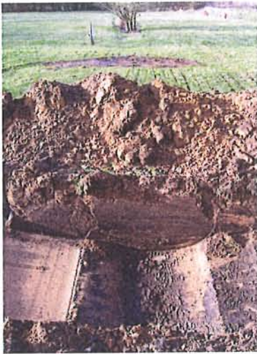
Foto 3.1 en 3.2.: Verzakkingen in het maaiveld
