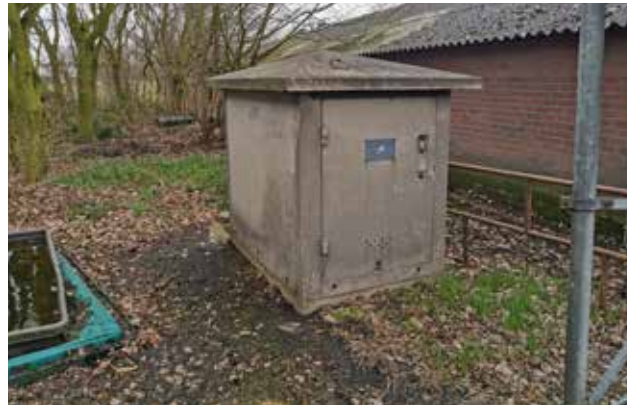
Figuur 13 Aanwezige trafo op het erf
