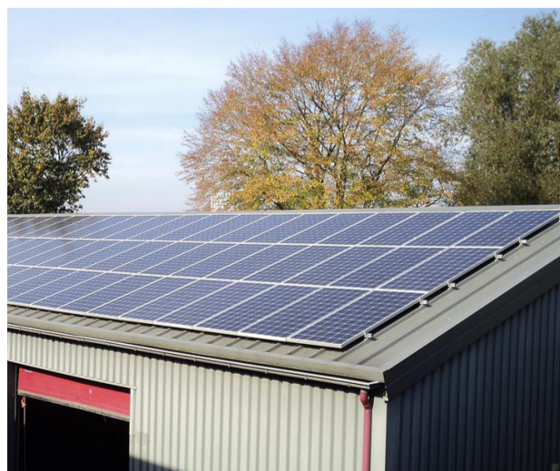
zonnepanelen op loods
