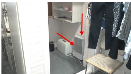
Foto 5 | koord achter asbesthoudende gevelkachel
