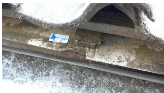
Foto 38 | dakbeschot van het bijgebouw
