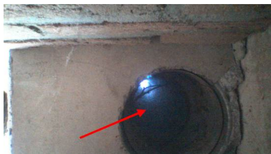
Foto 51 | rookkanaal begane grond
