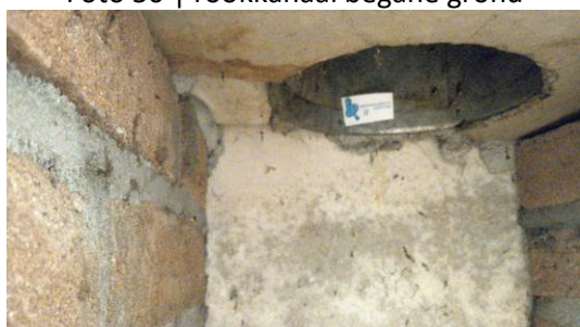
Foto 52 | rookkanaal begane grond
