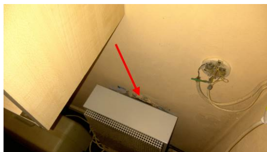
Foto 6 | koord achter asbesthoudende gevelkachel
