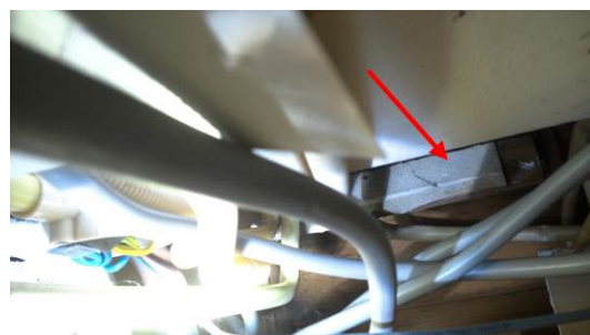
Foto 23 | strookje plaat in de meterkast
