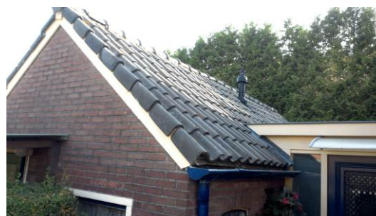
Foto 39 | dakbeschot van het bijgebouw
