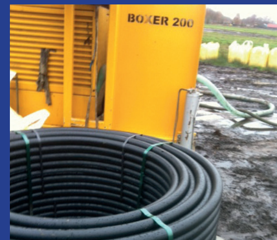
Gesloten bodem- energiesysteem
