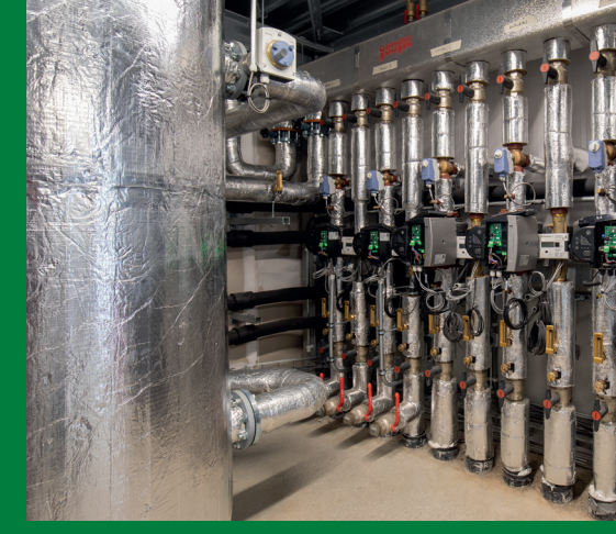
Lage temperatuur vloerverwarming
