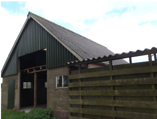
Foto 2, Bijgebouw met asbestdak
