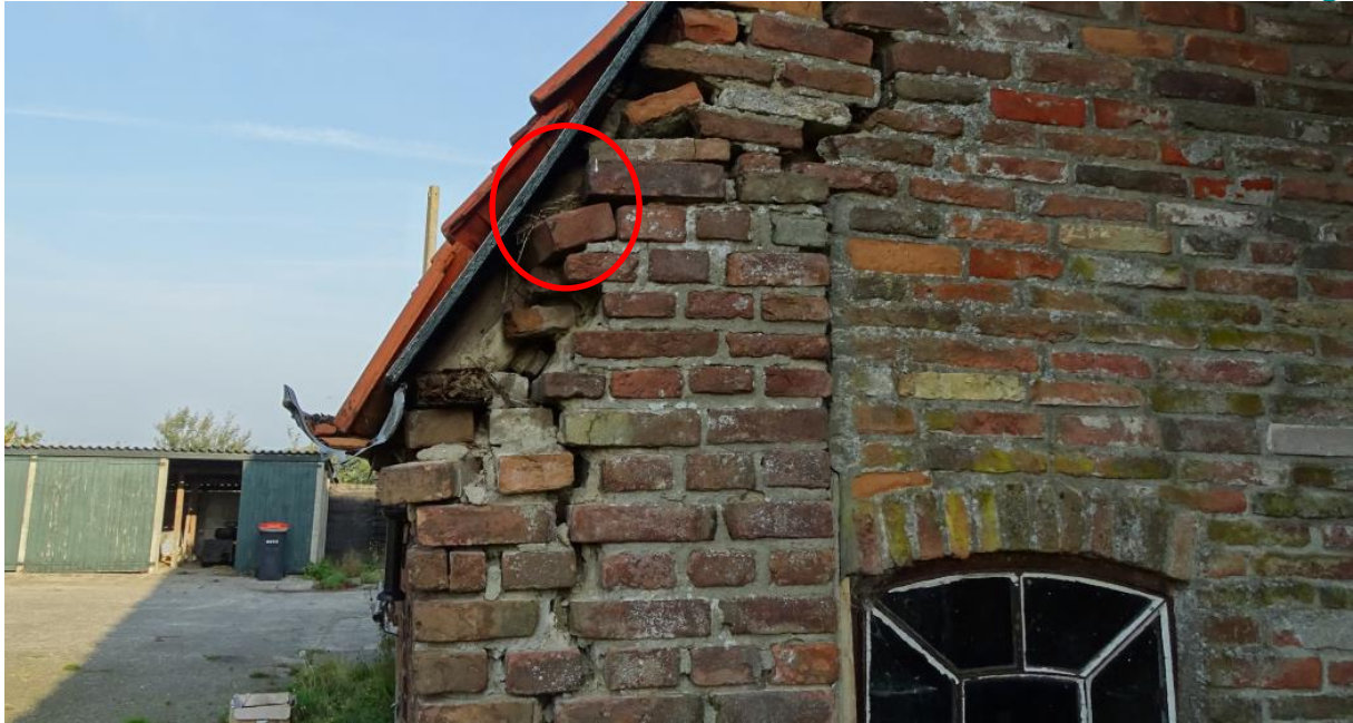
Figuur 5.3. Nest van een boerenzwaluw, tussen de zijgevel en dakbedekking.
