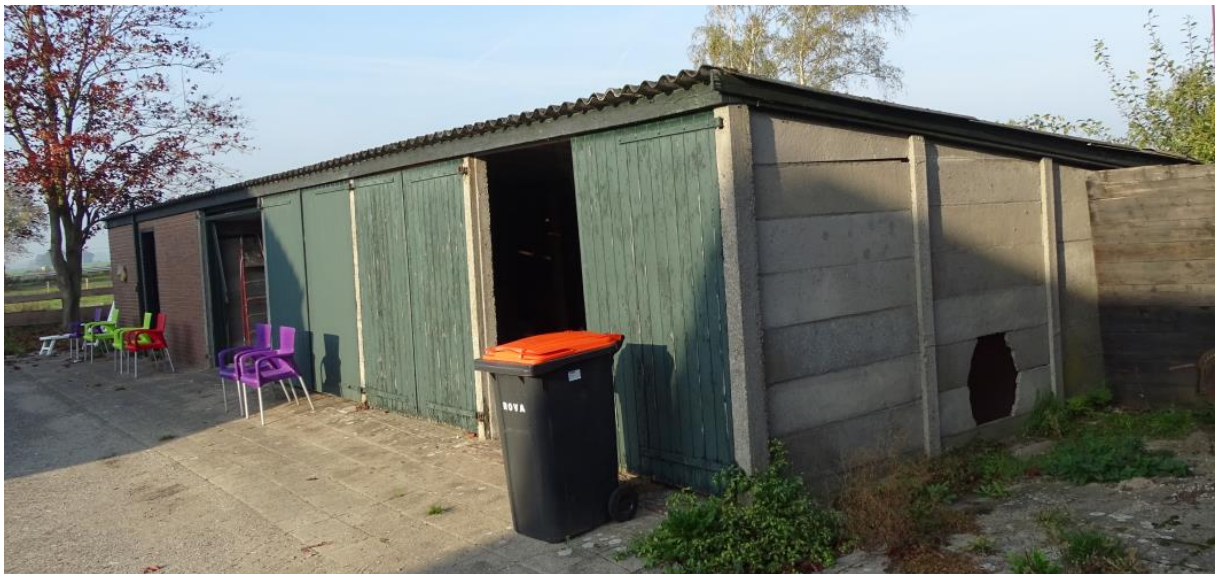
Figuur 2.7. Schuur / garage waarvan het dak wordt vervangen wegens asbest, gebouw 6 op figuur 2.2.
