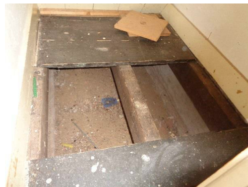
Onder vaste vloeren onderzocht
