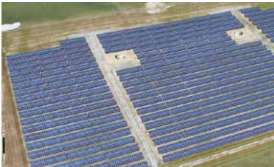
Trafo's in lijn van het zonneveld
