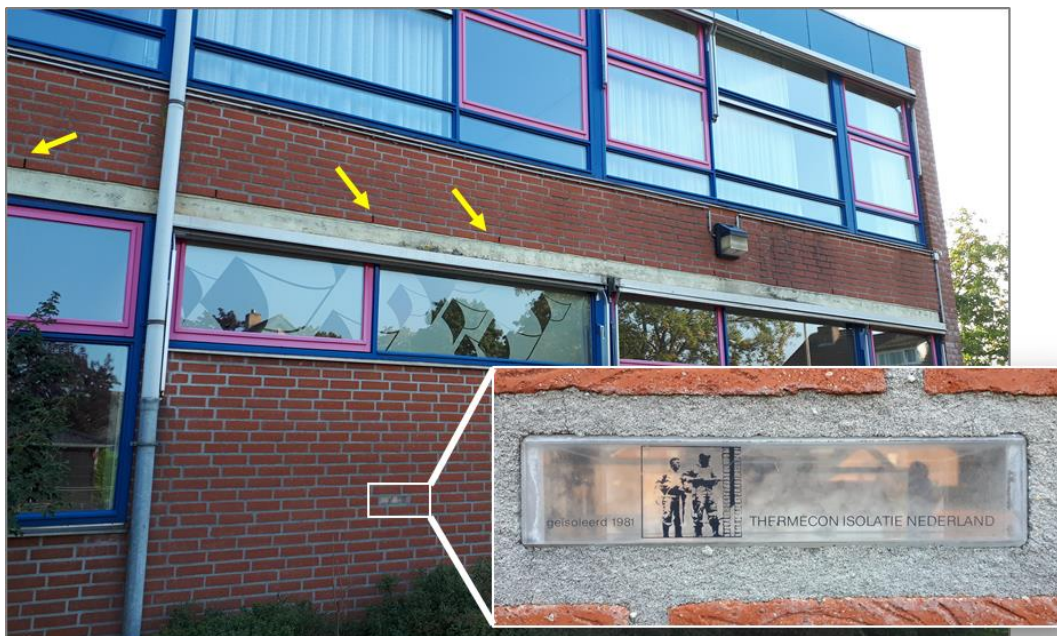
Figuur 3.2 Open stootvoegen (enkele aangegeven met gele pijlen) zijn voorbeelden van mogelijk geschikte invliegopeningen voor vleermuizen. De gevelsteen met informatie over de isolatie is rechtsonder uitvergroet. (Foto's: Ecogroen)
