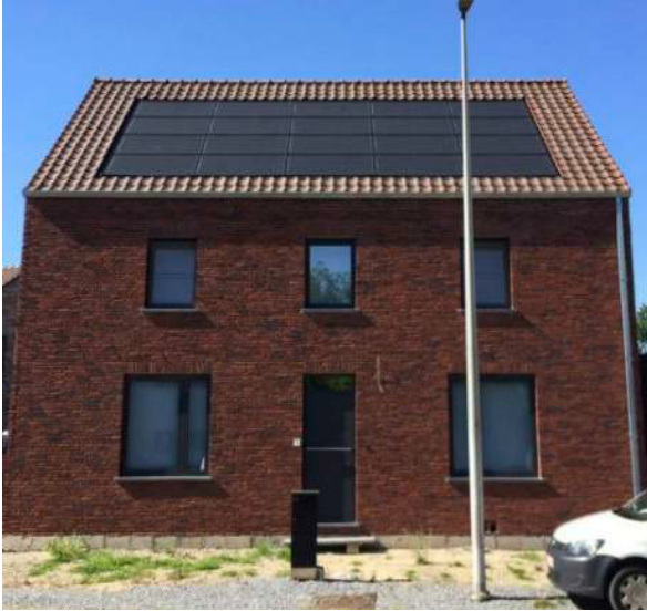
integratie pv panelen in het dak.
