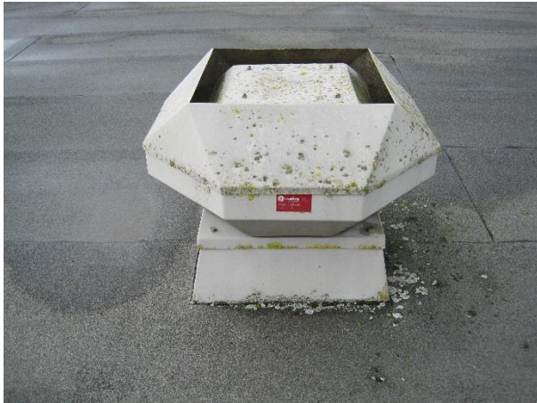
Afzuigventilator hoge dak
