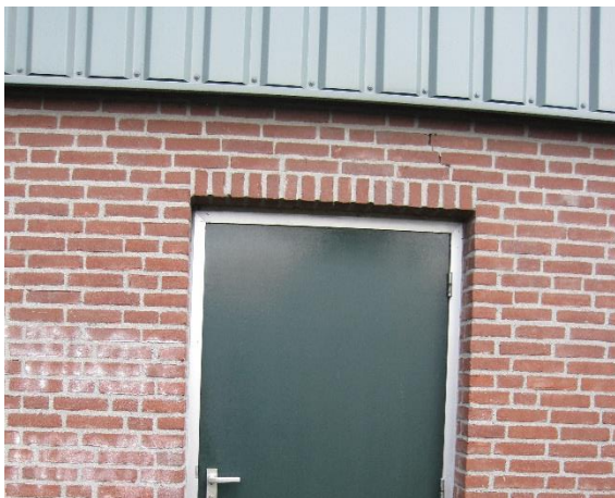
Scheurvorming boven deurkozijn
