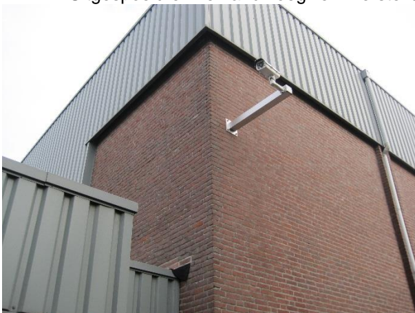
Verzand en uitgespoeld voegwerk
