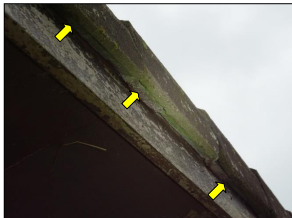
Figuur 10. Detailfoto van windveer en kantpannen. De ruimte tussen het dakbeschot/windveer en dakpannen is opgevuld met kunststof materiaal (zie gele pijlen).
