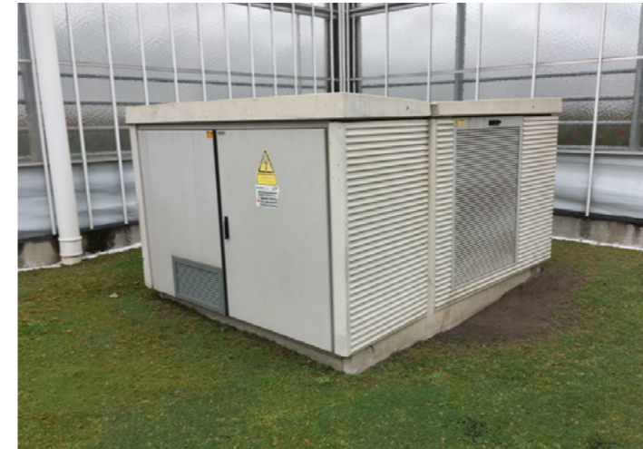
lage transformator en generator, kleurstelling antraciet
