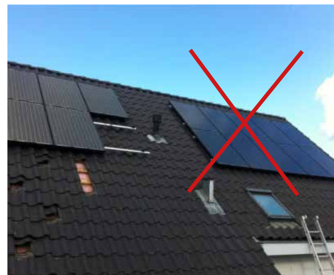
fout voorbeeld van zonnepanelen op het dak
