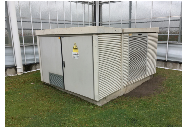
lage transformator en generator, kleurstelling antraciet
