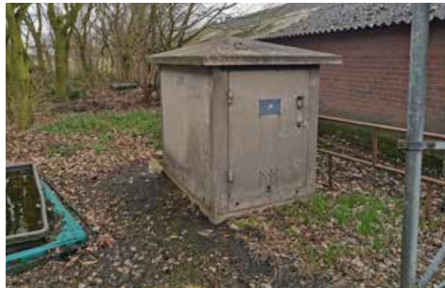
Figuur 13 Aanwezige trafo op het erf
