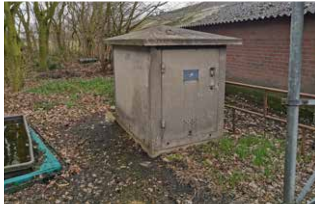
Figuur 13 Aanwezige trafo op het erf
