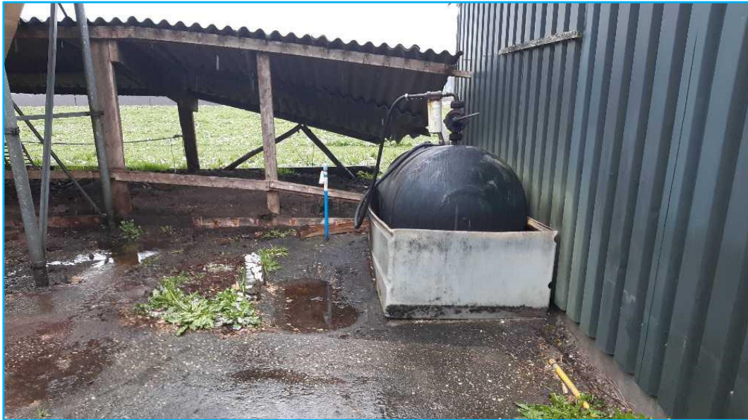
Foto 1: situatie bovengrondse tank
